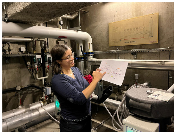
Visite de la sous-station de chauffage de la DSDEN du Rhône et du rectorat de l'académie de Lyon
