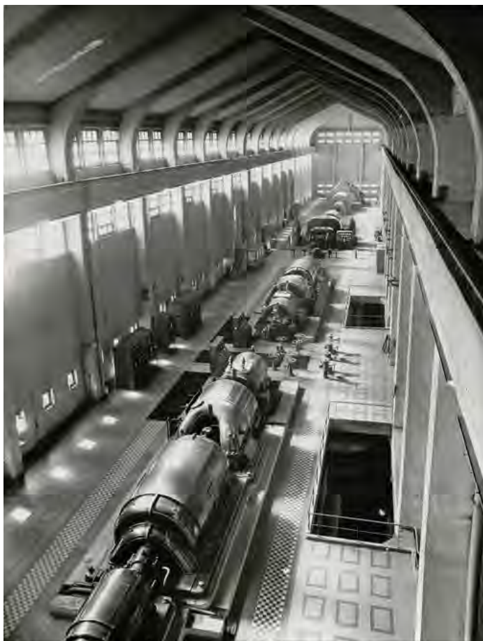
Ito Josué (1924-2010) Le Chambon-Feugerolles, la centrale électrique du Bec, la salle des compresseurs Vers 1960 Couriot-Musée de la Mine, inv. 2008.0.859
